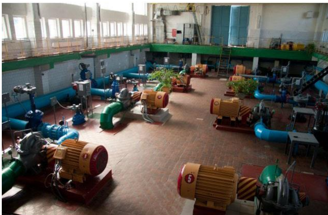
Малюнок 12 - Деснянська водопровідна станція ПАТ "АК"Київводоканал". Насосна станція
