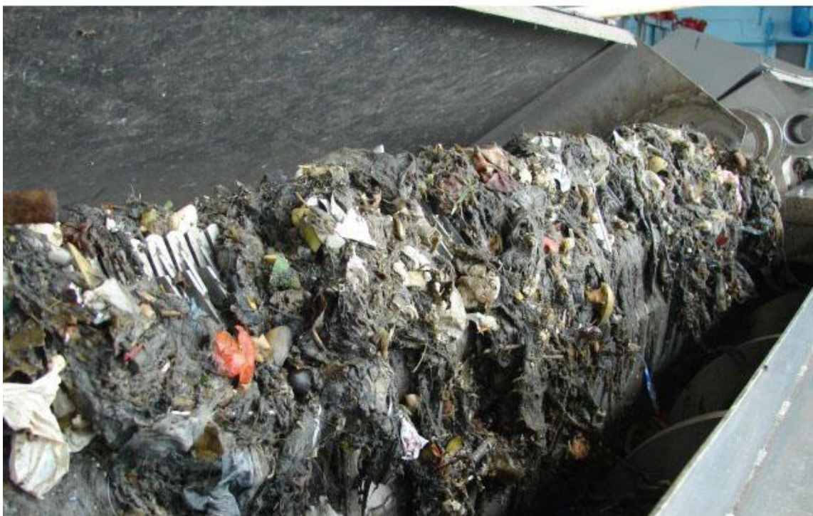
Малюнок 14 - Бортницька станція аерації ПАТ "АК"Київводоканал". Грабельне відділення
