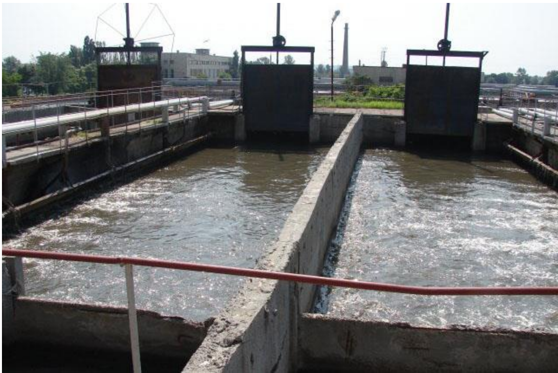
Малюнок 15 - Бортницька станція аерації ПАТ "АК"Київводоканал". Відвідний канал
