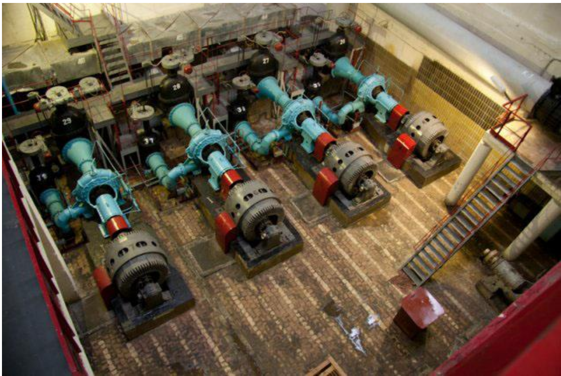
Малюнок 13 – Дніпровська водопровідна станція ПАТ "АК"Київводоканал". Насосний зал
