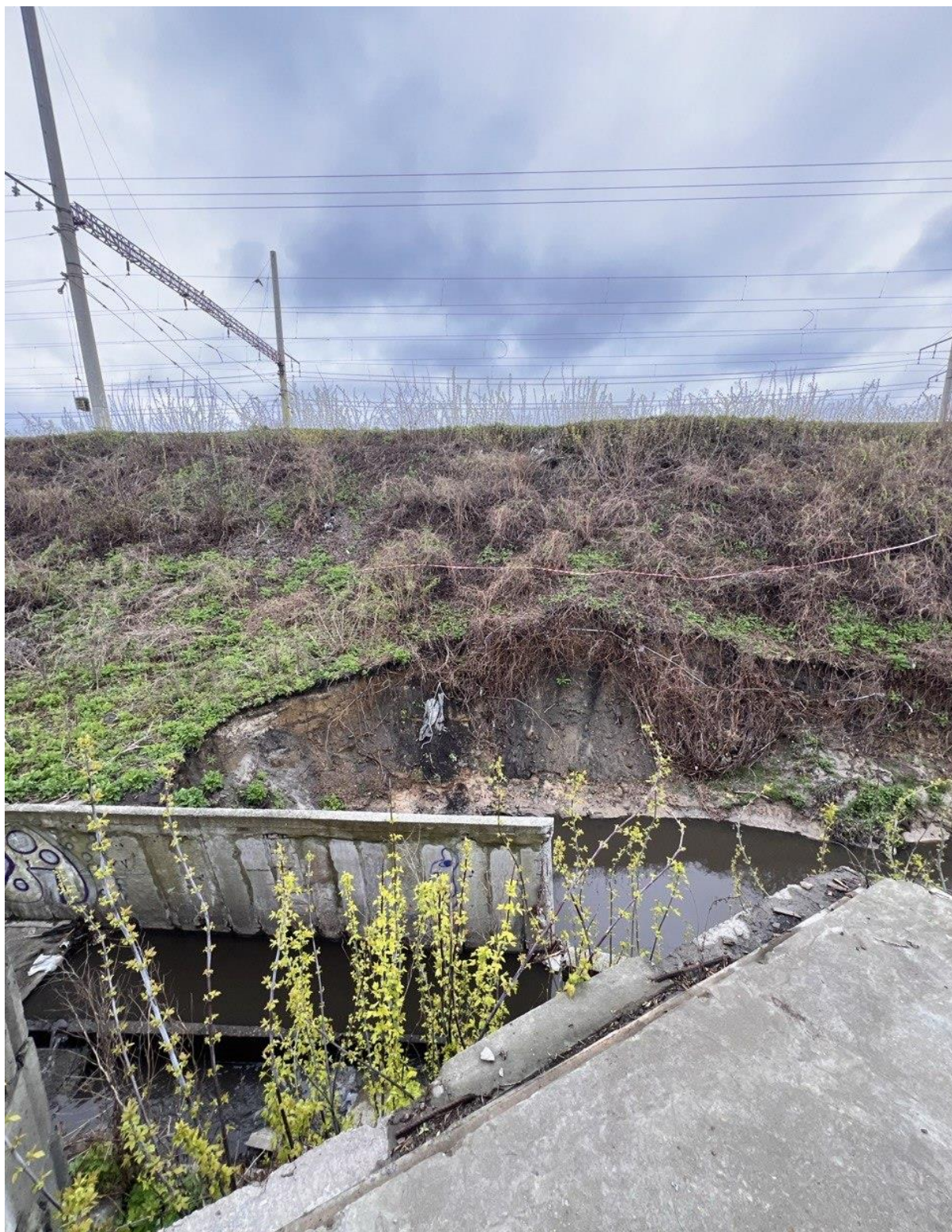
Фото 1 – Обвал елементів берегоукріплення русла р. Либідь. Руйнування укосу залізниці по правому березі річки
