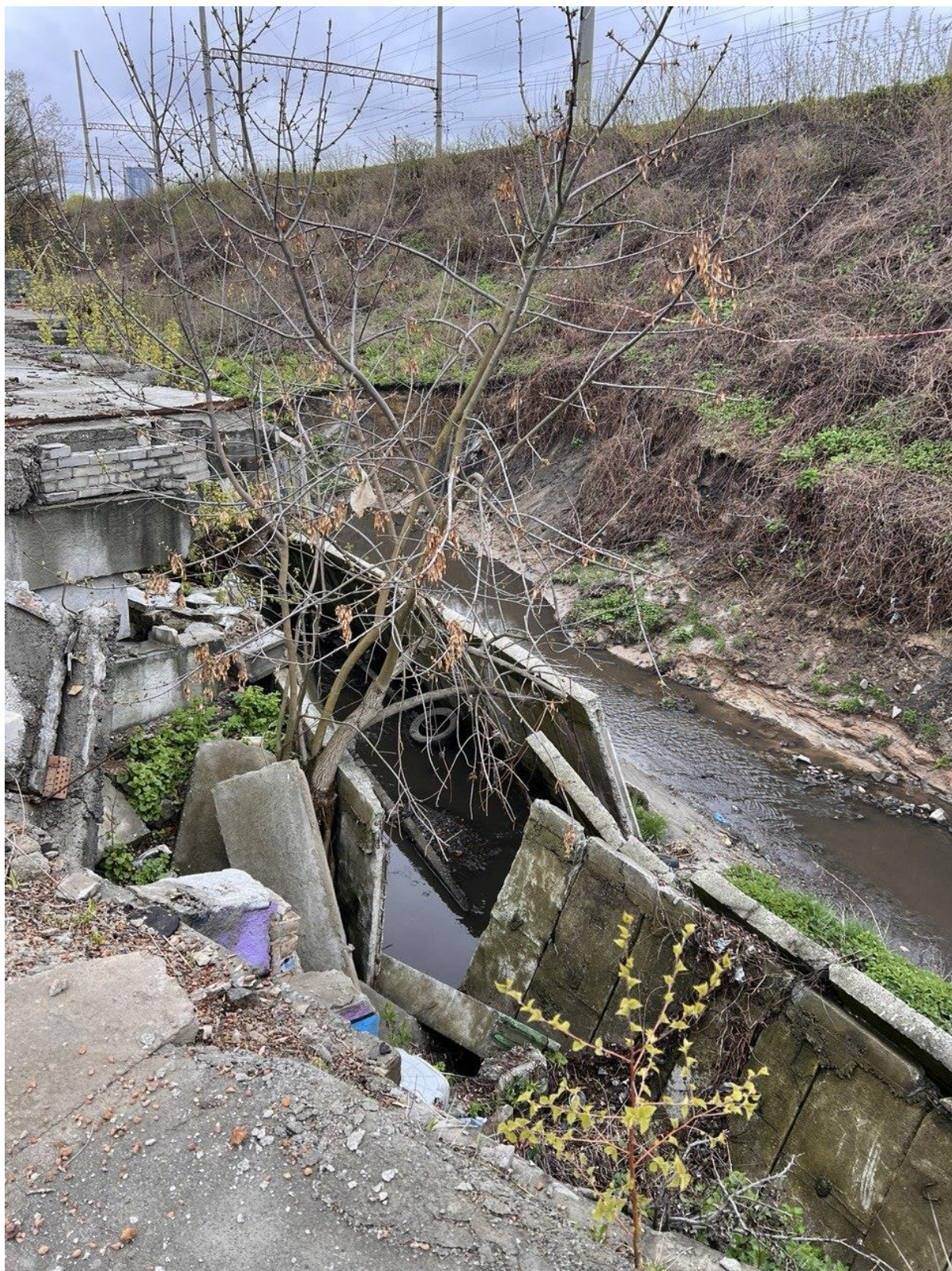
Фото 2 – Обвал елементів берегоукріплення русла р. Либідь. Руйнування укосу залізниці по правому березі річки та споруд гаражів по лівому березі
