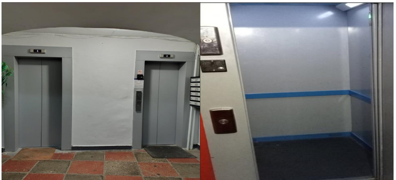
Реконструкція та заміна ліфтів на просп. Георгія Гонгадзе, 20г, під. 1 та на просп. Василя Порика, 15, під. 6
